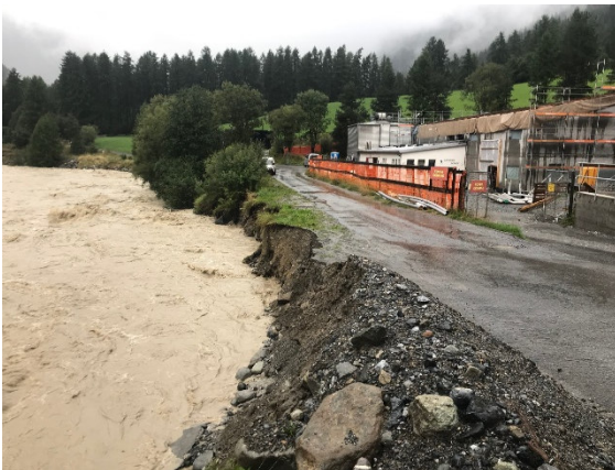
Abbildung 24: Ufererosion infolge Hochwasserereignis von Mitte August (Foto: C. Bott).
