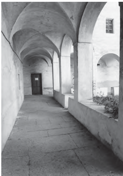
Abb. 89: Poschiavo, altes Frauenkloster. Der Innenhof aus der zweiten Hälfte des 17. Jahrhunderts. Zustand vor der Restaurierung.
