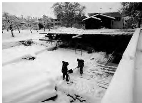
Abb. 81: Trimmis, ev. Kirchgemeindehaus. Die Ausgrabung im Dezember 1999. Im Hintergrund das Pfarrhaus. Blick von Südosten.
