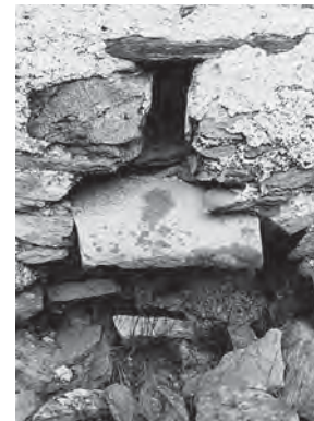
Abb. 154: Alp da Cavloc, Alte Sennerei. Ausguss an der Südfassade, von wo die Schotte direkt in einen aussen liegenden Schweinetrog geleitet wurde.
