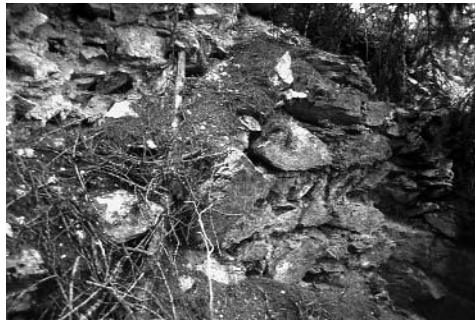
Abb. 4: Müstair, Burgruine Balcun At. Lagiger Mauerrest des «Turms» über der Steilwand zum Val Brüna.
