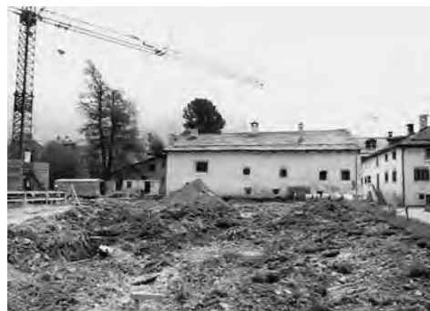
Abb. 148: Sils i.E./Segl, Baselgia/nördlich Haus Suosta Veglia. Übersicht der Baustelle am Beginn der Ausführung. Blick von Norden.
