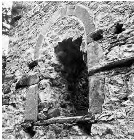
Abb. 204: Brienz/Brinzauls, Burgruine Belfort. Der zugemauerte Eingang in der Nordwand des Torturmes. Ansicht von Norden.
