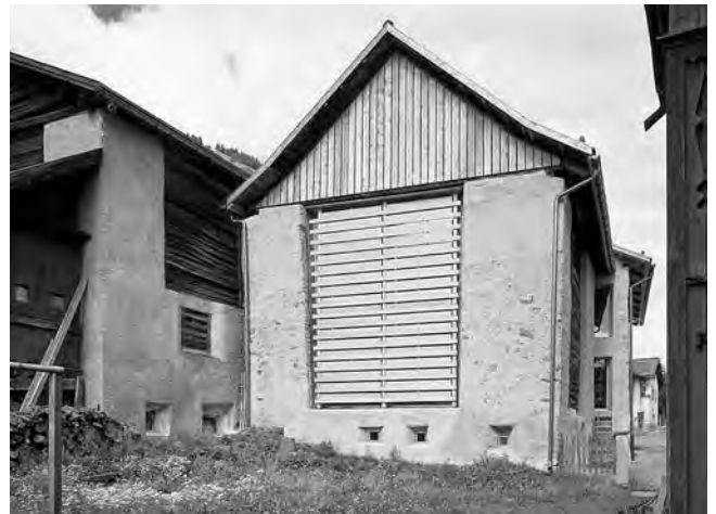
Abb. 244: S-chanf, Haus Nr. 120. Heustallfassade. Die Heubelüftungsöffnungen wurden von innen verglast und nach aussen mit einer groben verstellbaren schattenspendenden Lamellenkonstruktion versehen. Das „Bild“ ist neu, das Wesen des Gebäudeteils erhalten.
