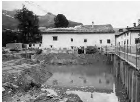
Abb. 152: Sils i. E./Segl, Baselgia/nördlich Haus Suosta Veglia. Baugrube nach Anstieg des Grundwasserspiegels. Blick von Norden.
