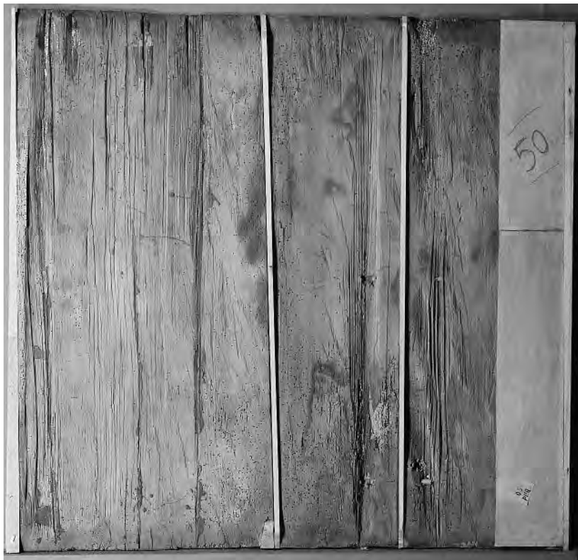
Abb. 120: Zillis-Reischen, Kirche St. Martin, Bilderdecke, Tafel 50. Streiflichtaufnahme der Rückseite, welche die beim Spalten der Bretter entstandenen Bearbeitungsspuren und Vertiefungen durch ausreissende Fasern sichtbar werden lässt. Ebenso zu erkennen sind die geglätteten Bereiche (flache Stellen). Anstückungen, Fugenleisten sowie Holzverstärkungen mit Sperrholz stammen von der Restaurierung 1938-41, ebenso die Holz Sicherungen, welche als verdunkelte, leicht glänzende Stellen in Erscheinung treten. Am rechten, originalen Brettteil ist eine aufgebrochene Stelle mit starkem Insektenbefall zu erkennen.
