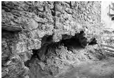
Abb. 148: Brienz/Brinzauls, Burgruine Belfort. Unter- minierung der Nordwand, von Nordosten.
