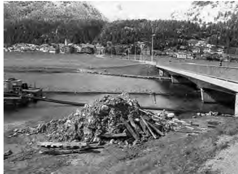
Abb. 71: Silvaplana, Brücke Surlej. Die aus dem Seegrund gerissenen und am Ostufer deponierten Balken und Bohlen. Links im Bild die schwimmende Arbeitsplattform, von der aus die Leitungen verlegt wurden. Blick gegen Norden.
