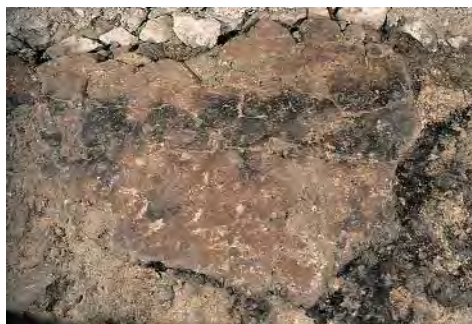
Abb. 29: Müstair, Kloster St. Johann. Sakristei 8, Detailansicht auf den mit rot eingefärbten, karolingischen Mörtelboden, am linken Bildrand die mit roter Spachtelmasse ausgeflickte Stelle.
