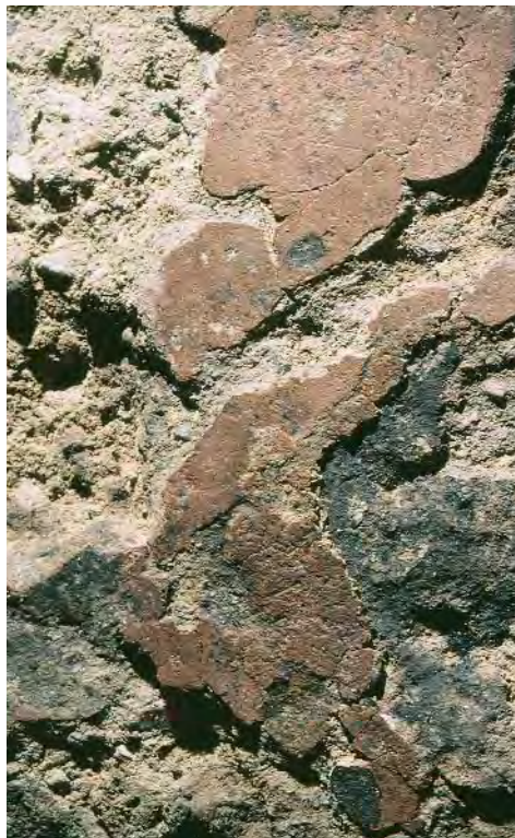
Abb. 28: Müstair, Kloster St. Johann. Sakristei 8, Detailansicht auf den mit Ziegelmehl rot eingefärbten, karolingischen Mörtelboden, darauf Spuren vom verbrannten Mobiliar (Sitzbank).
