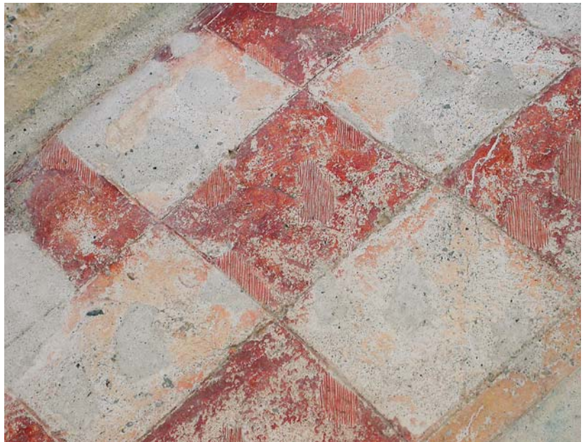
Abb. 79: Chur, Kathedrale St. Mariä Himmelfahrt, Altarhaus, Ostwand. Neue Kittungen und Trategio-Retuschen in den Rotbereichen des Giebfrieses.
