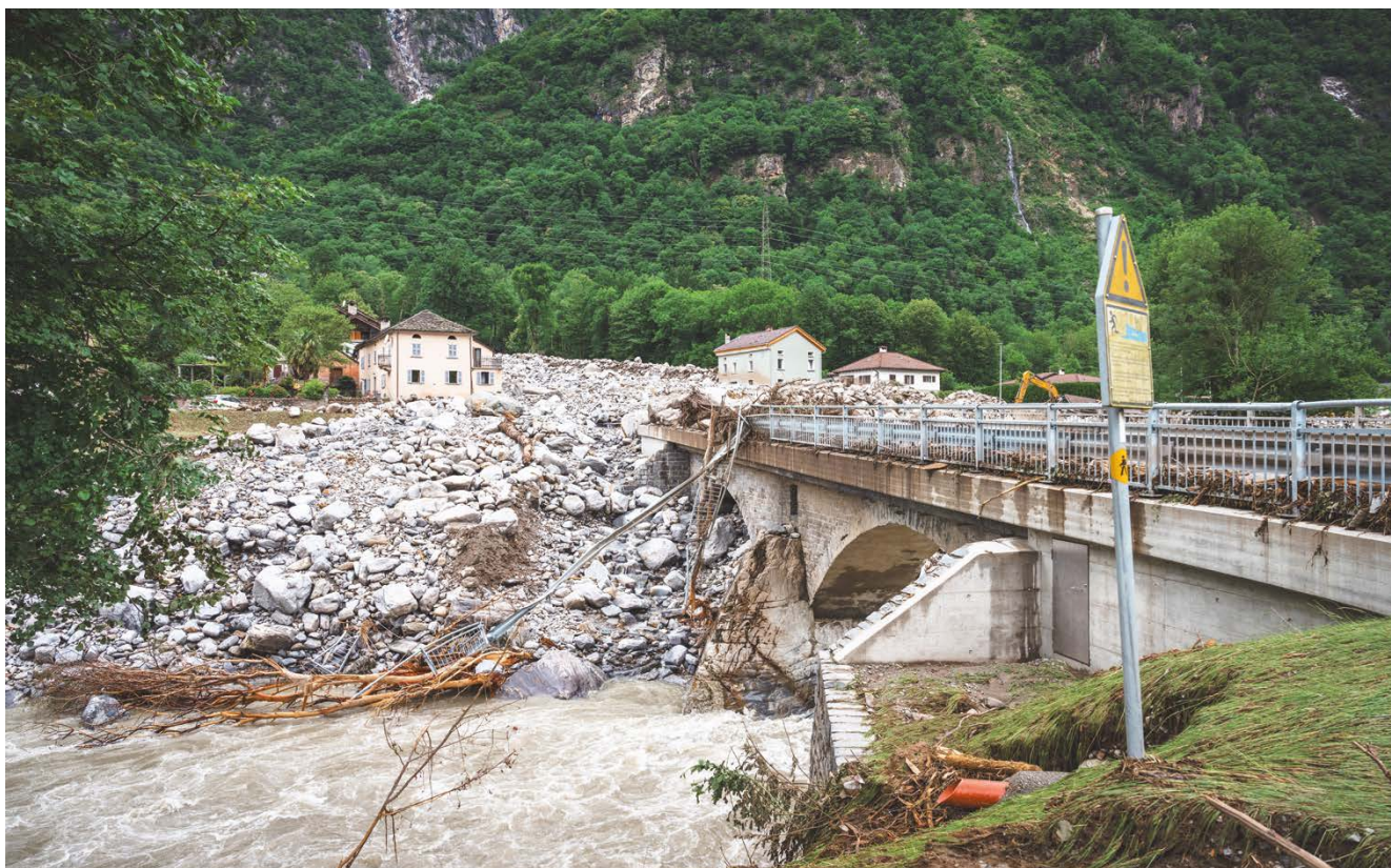
Abbildung 24: Ein Murgangereignis in die Rià de la Molera verschüttete einen Teil der Ortschaft Sorte (Quelle: Foto Censi, 2024)
