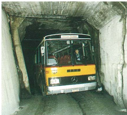
Die vom Rutschhang malträtierte Betonkonstruktion im Jahr 1988
