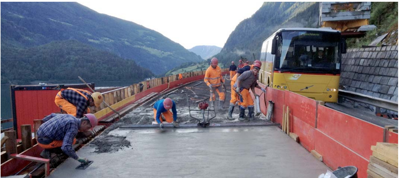
Getto del calcestruzzo sulla piattaforma stradale in condizioni di spazio limitate accanto al traffico a senso alternato.
