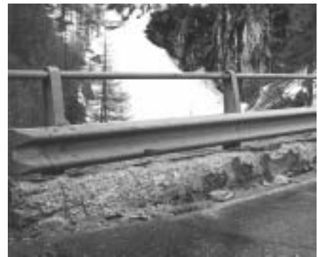
Durch Frost und Tausalz stark beschädigter Kordon der Bardella-Brücke bei Marmorera
