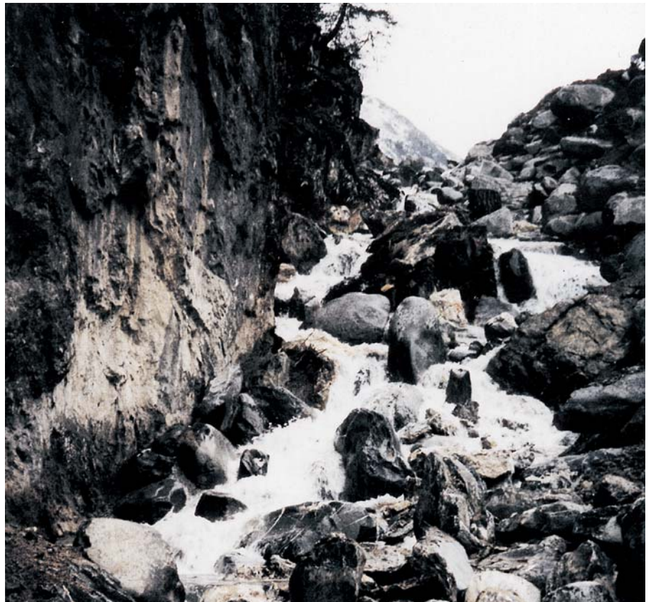
Der Stützbach in seinem neuen Gerinnebett, hier mit Blick in die Steilstrecke. Gut erkennbar die rauhe Sohlengestaltung zur Reduzierung der Fliessgeschwindigkeit.
