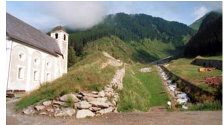
Lawinenablenkdamm beim Val San Plazi bei Disentis
