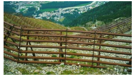
Stützverbauungen im Anrissgebiet oberhalb Pontresina
