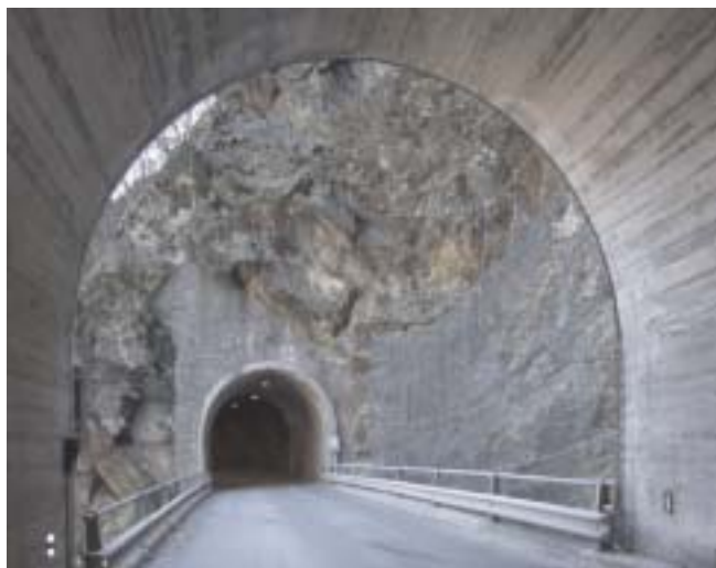
Vista sul ponte e sull'ambito del portale esposto al pericolo Blick auf die Brücke und den gefährdeten Portalbereich
