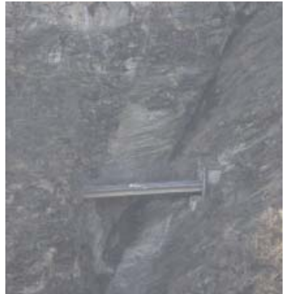
Die Brücke Val d'Infern mit der fels- und steinschlaggefährdeten Tobelflanke links im Bild
