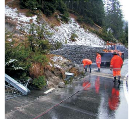
Aufräumarbeiten nach Hangrutschung
