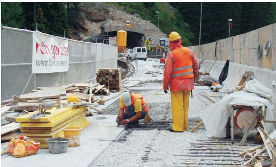
Freilegen der korrodierten Armierung auf der Traversabrücke
