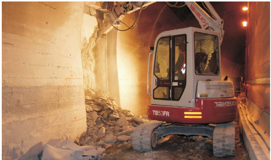
Ausbruch einer Entwässerungsnische von der gesperrten Fahrbahn aus
