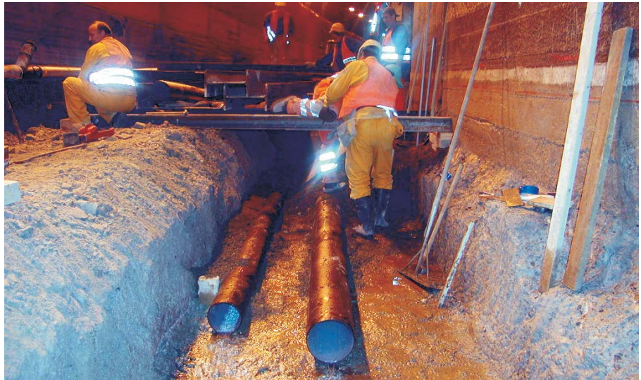
Das neue Werkleitungstrasse im Tunnel Rofla
