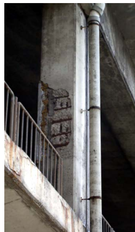
Pilone gravemente danneggiato
