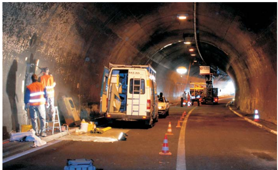
Rund um die Uhr wird an der Wiederherstellung der Sicherheitseinrichtungen und der glücklicherweise nur teilweise beschädigten Bausubstanz gearbeitet.
