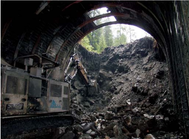
Der provozierte Tagbruch beim Portal Seite Mutten
