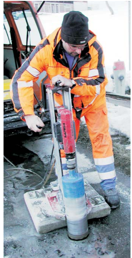
Entnahme von Bohrkern mit Durchmesser 150 mm aus Strassenbelag zur nachfolgenden Prüfung im Labor
