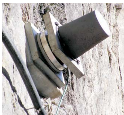
Ankerkopf eines vorgespannten Felsankers, ausgerüstet mit elektrischer Kraftmessdose
