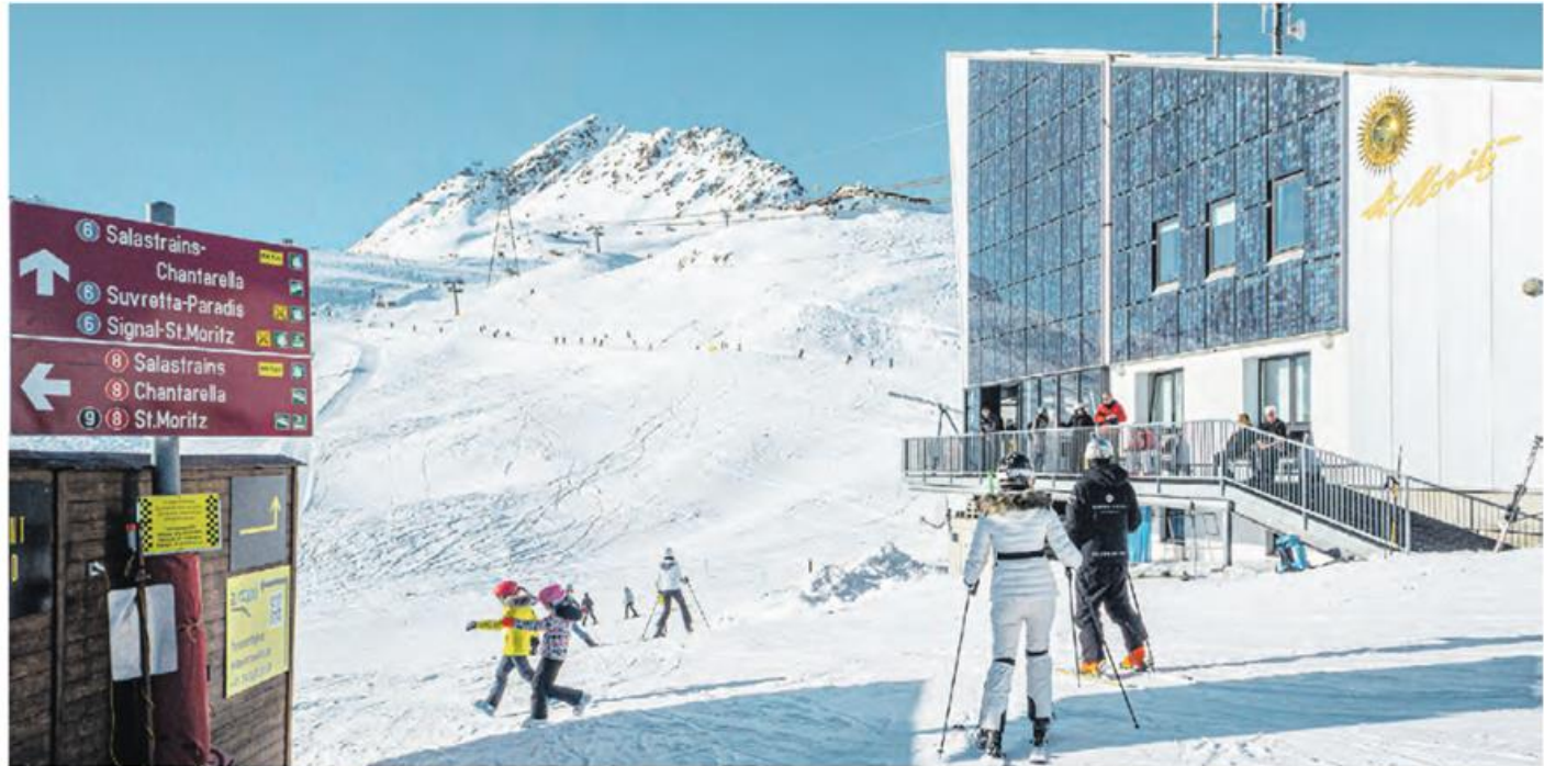
Die Photovoltaikanlage an der Südfassade der Talstation der Luftseilbahn Corviglia/Piz Nair auf 2484 Metern über Meer produziert gemäss Clean Energy jährlich rund 11 500 kWh Strom. Von der Anlage an der Piz-Nair-Bergstation kommen weitere 13 000 kWh.
