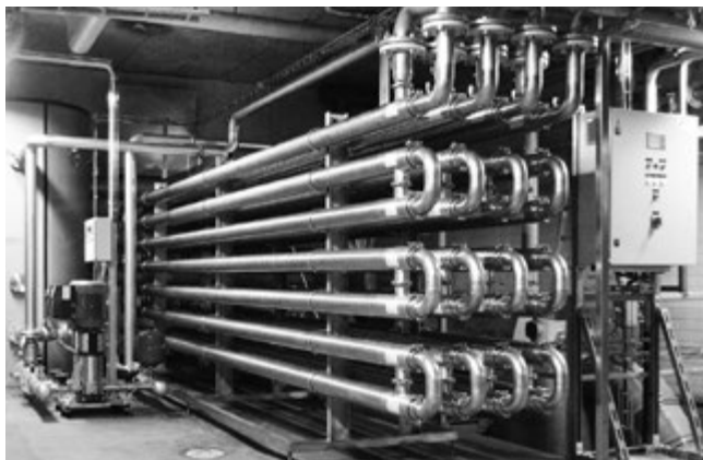
Abbildung 6: Wärmerückgewinnung aus Schmutzwasser in einer Wäscherei.
