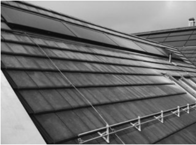
Abbildung 1: Dachansicht mit der Photovoltaikanlage (hinten) und PVT-Zellen (vorne).
