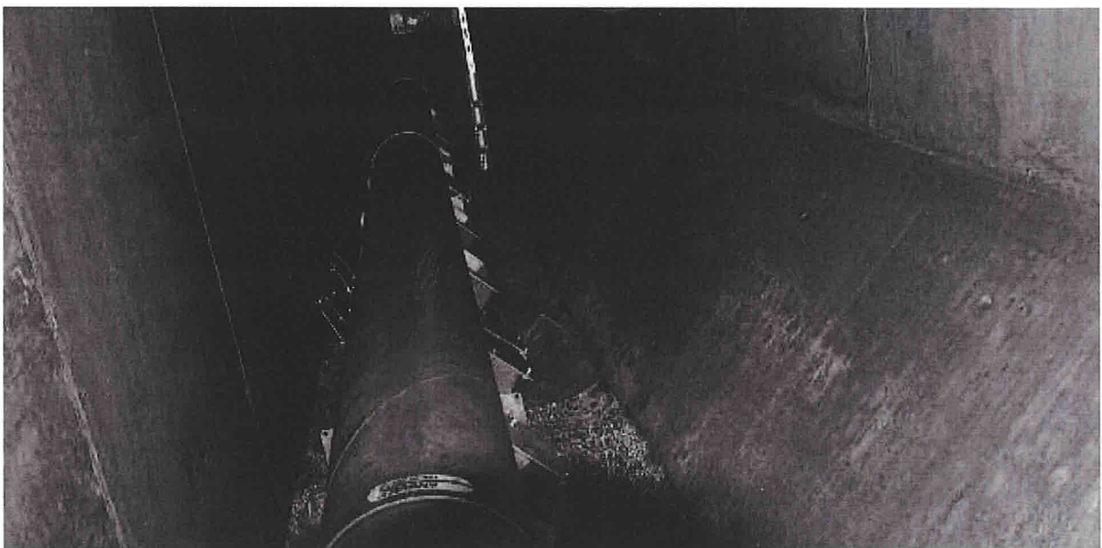
Abbildung 4: Beispiel eines Entsanders mit HSR-Abzugssystem, KW Mühlebach, Engi GL (Referenz Sitec)
