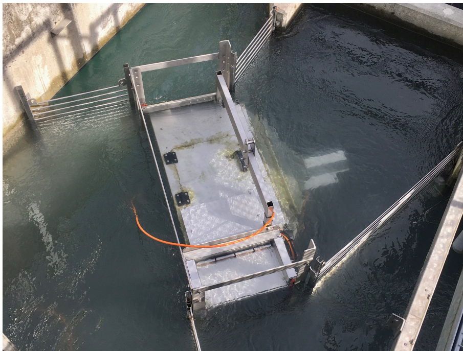
Abb. 1: Installation des Riverwatchers in der FAA am KW Reichenau
