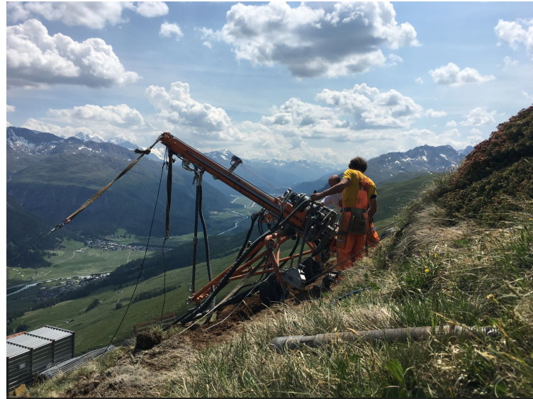
Abbildung 2: Gebirgsbaustelle oberhalb von Zuoz in der Lawinenverbauung Albanas. Mit dem Bohrgerät werden Bohrlöcher mit einer Länge von bis zu 8 m und einem Durchmesser von rund 105 mm abgeteuft. Die erforderliche Bohrlänge hängt von der Tragfähigkeit des Bodens ab und wird objektspezifisch mit Versuchen ermittelt (Quelle: G. C. Feuerstein, 2017).
