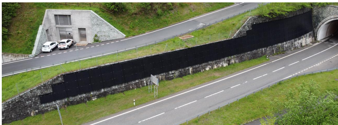
Abbildung 19 PV-Anlage an einer Natursteinvorgemauerten-Wandmauer beim Tunnel Rongellen II
