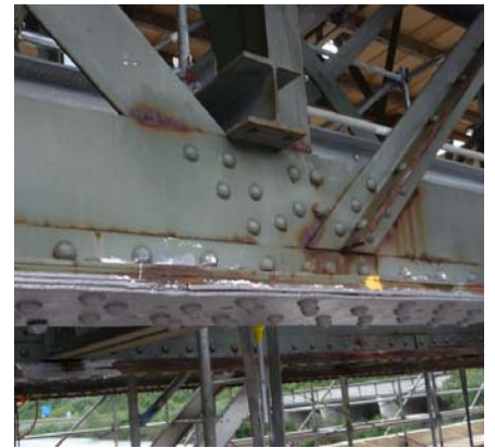
Korrosionsschäden an einem genieteten Fachwerkknoten von 1881
