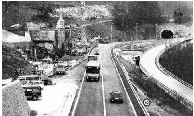
Portalbereich Rongellen in einer Aufnahme von 1994: links die Baugrube für das Südportal des Crapteig Tunnels, in der Mitte die heutige N13, rechts die Lokalstrasse.
