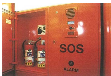
Blick in eine SOS-Kabine
