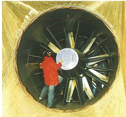
Ventilator beim Südportal
