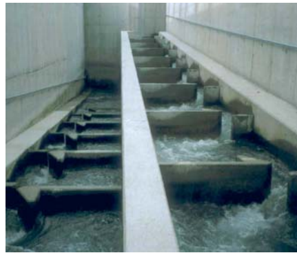
Blick in die Fischpassanlage mit den deutlich erkennbaren vertikalen Schlitzen zwischen den einzelnen Kammern
