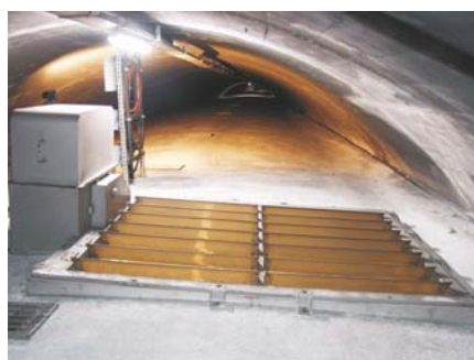
Beispiel eines Lüftungskanals mit geöffneten Brandklappen
