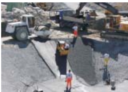
Retentions- und Filterbecken Selfranga, Sommer 2002
