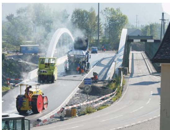
Einbau des Asphaltbelages auf der Brücke, rechts im Vergleich die alte Fachwerkbrücke
