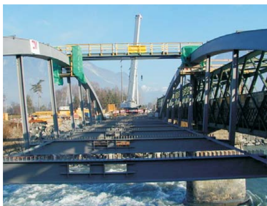
Der an den Bogen aufgehängte Stahlträgerrost als Tragkonstruktion der Fahrbahnplatte aus Beton
