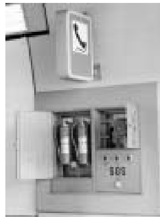
Ungenügende Sicherheitsausrüstung Dispositivi di sicurezza insufficienti
