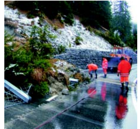
Aufräumarbeiten nach Hangrutschung
