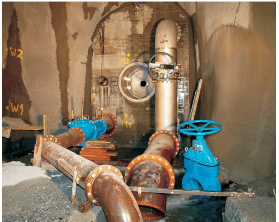
Rohranlage mit Schiebern für den kontrollierten Rückstau der Karstquelle im Tunnel Flimserstein/Crap da Flem
