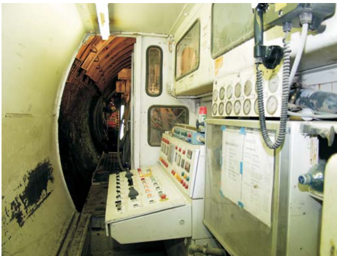
Blick in den Kontrollraum der Tunnelbohrmaschine
