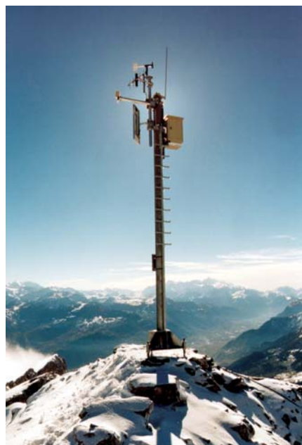
Windstation einer IMIS-Anlage
