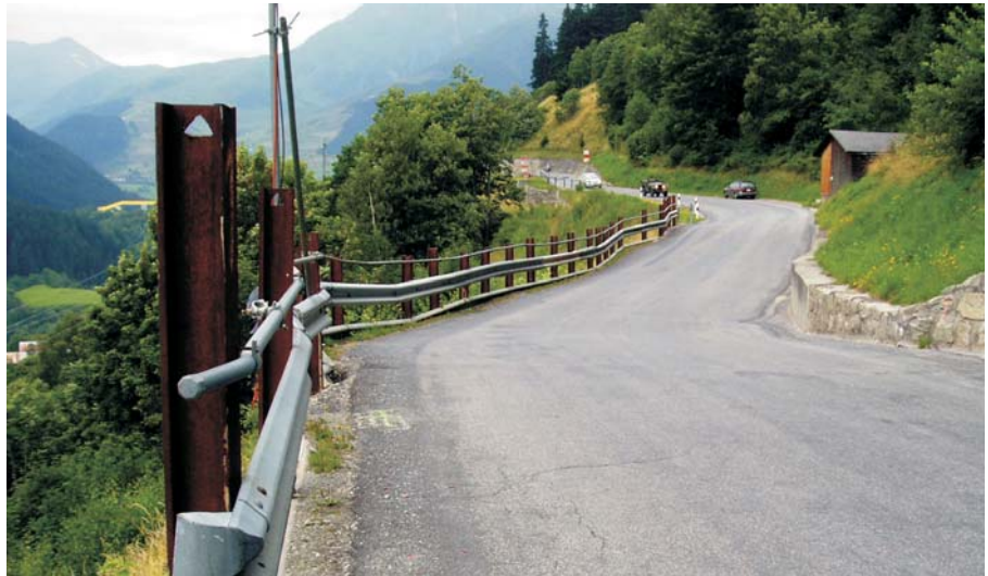
Der heutige Zustand des Strassenabschnittes Garmischeras – Tscheppe zeigt deutlich die Spuren der besonders in den 1980-er Jahren aktiven Hangverschiebungen.
