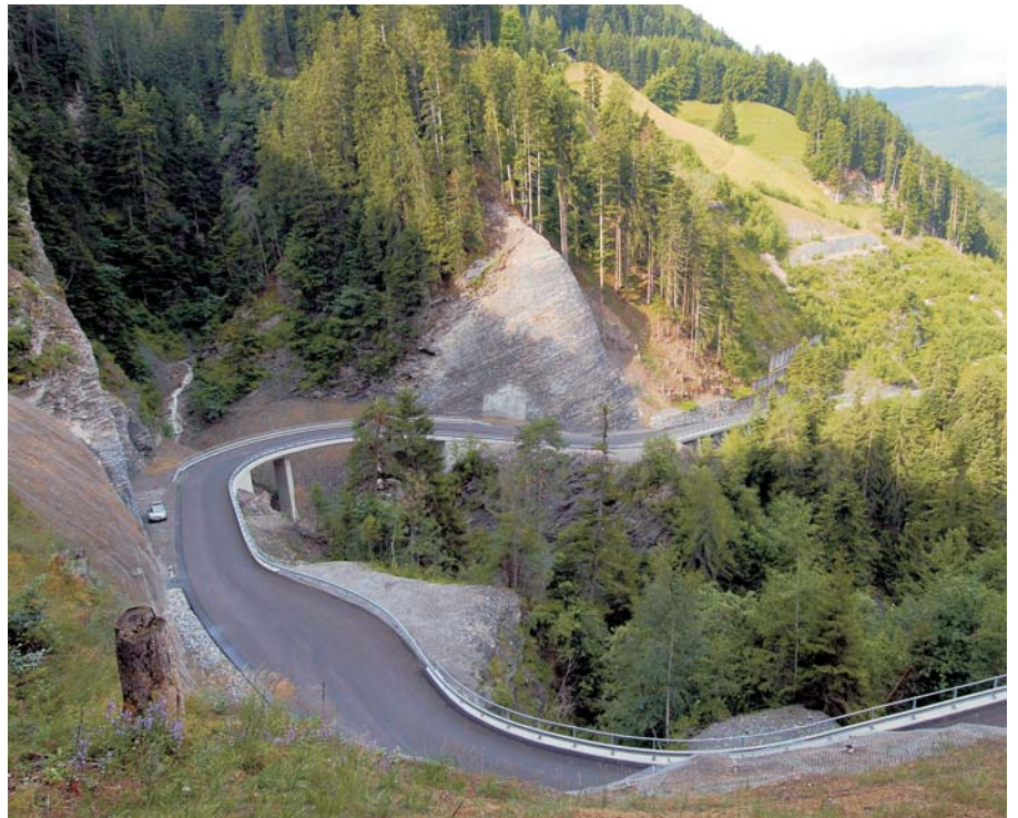
Die neu angelegte Tschierschenstrasse im Steinbachtobel, rechts im Bild Ricaldei mit dem Materialabtrag beim Felskopf und den Ankerwiderlagern
