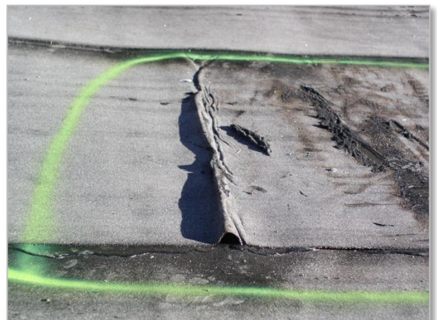
Unsorgfältiger Einbau (maschinell)
