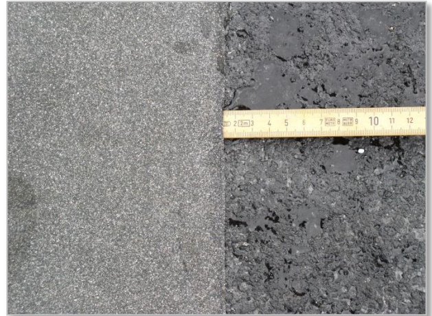
Ungenügend aufgeflämmtter Rand
