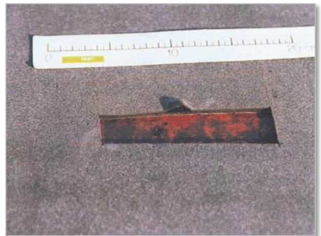
Aufgeschnittener Blasenohlraum zwischen Träger- einlage und oberer Dichtungsmasse
