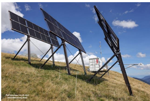
Impianto di prova Scharinas, Tujetsch
