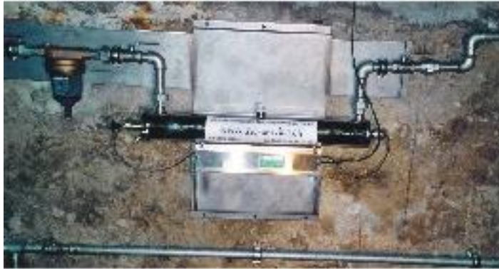
Wasserdurchlaufstrahler auf einer Alp mit 240 Volt
