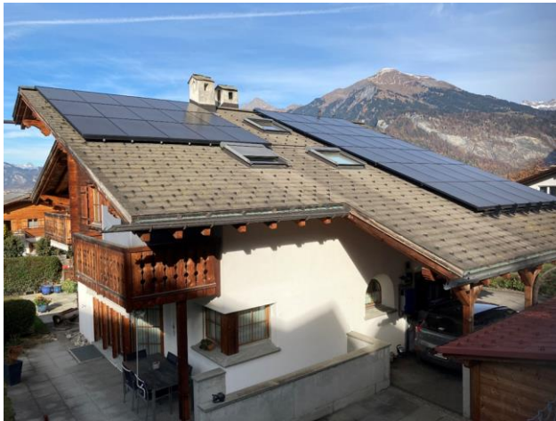
Figura 1: Impianto fotovoltaico a Igis
