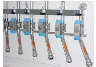
Punto di riempimento di una cisterna fissa (ditta Halag, Canton Turgovia)
