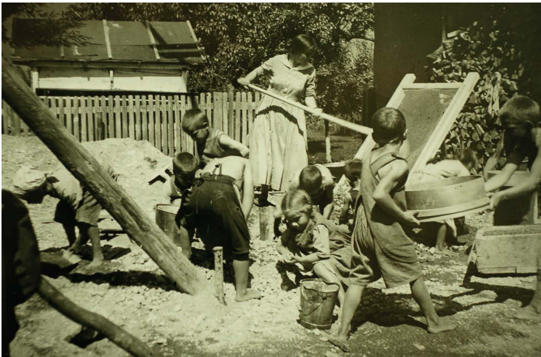
Nicht nur die Knaben halfen bei den Bauarbeiten, auch «unsere Töchter mit Kopftüchern & Arbeitsschürzen sieben Sand auf Mord & Brand». Manchmal gab es für solche Spezialaufgaben ein kleines Taschengeld (Aufnahme um 1923).
