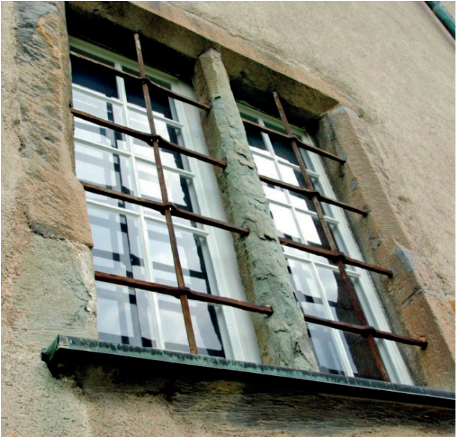
Abb. 5: Nord-Westfassade: Fenstereinfassung in Scalärastein. Mittelgewände in Sandstein mit abgewitterter, sandender Oberfläche und grösserer Schalenbildung.
