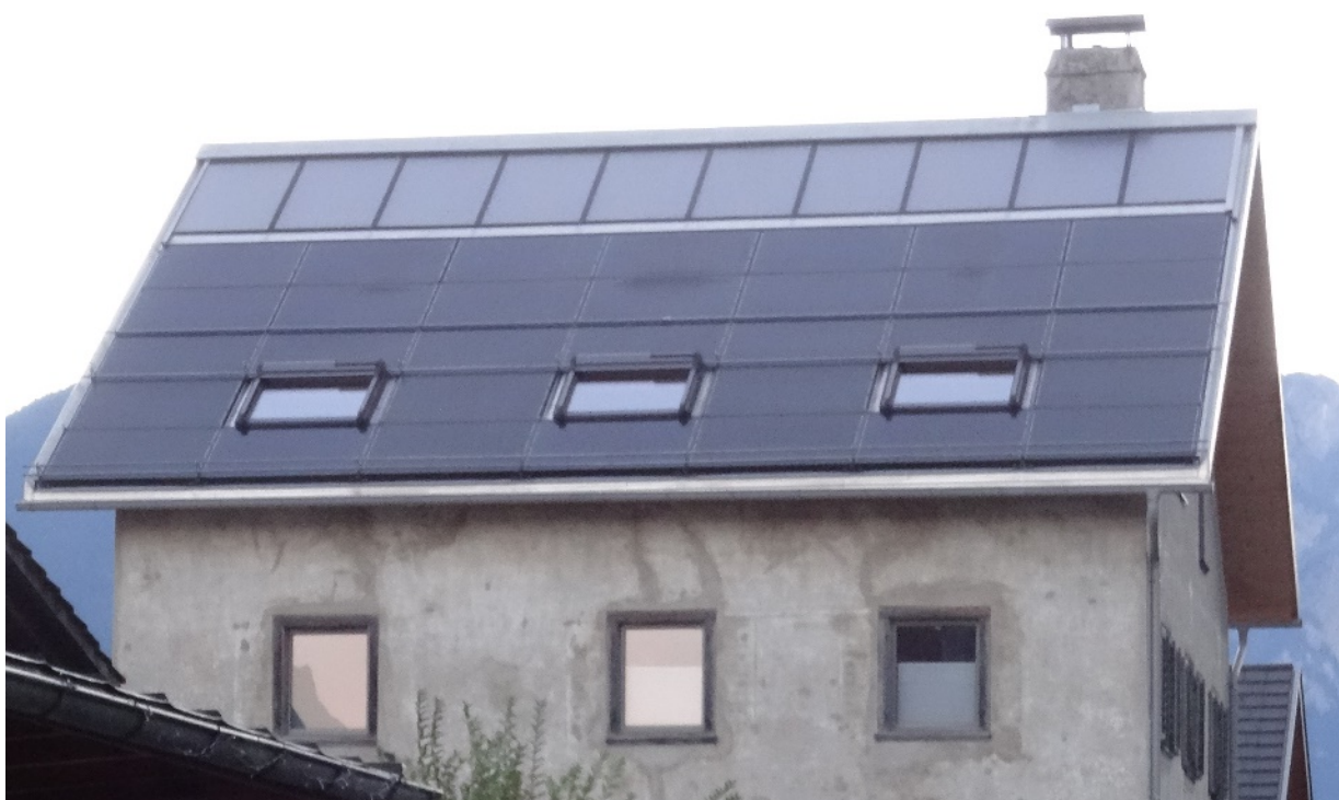
Abb. 29: Integrierte PV-Anlage mit thermischen Kollektoren, Quelle: Peter Müller
