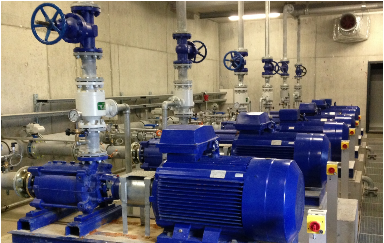
Abb. 37: Pumpengruppe für Beschneigungsanlagen, Quelle: Peter Müller
