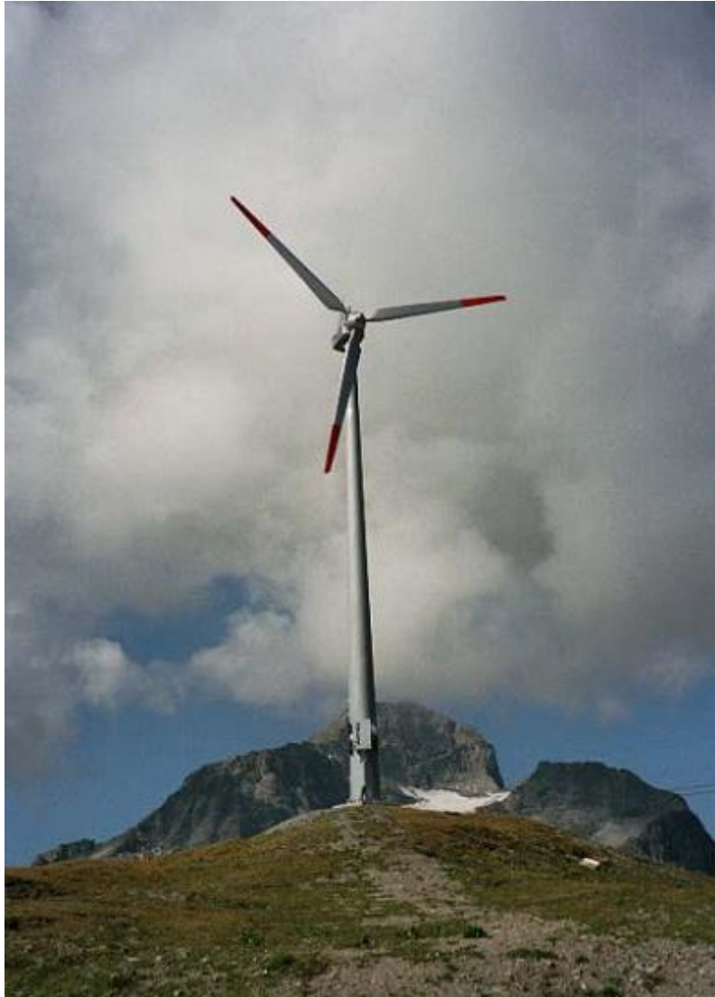
Foto 2: Windkraftanlage St. Moritz (Quelle: Aventa AG)
