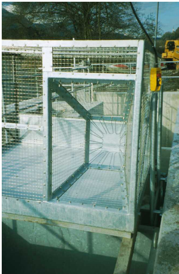
Abb. 10: Heben der Kontrollreuse in der Fischpassanlage beim Kraftwerk Reichenau.
